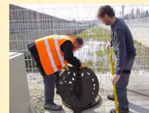
Tampon monté à l'envers
