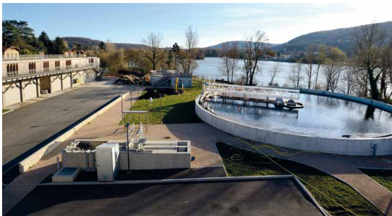
Station de traitement des eaux usées à Neuville-sur-Saône
