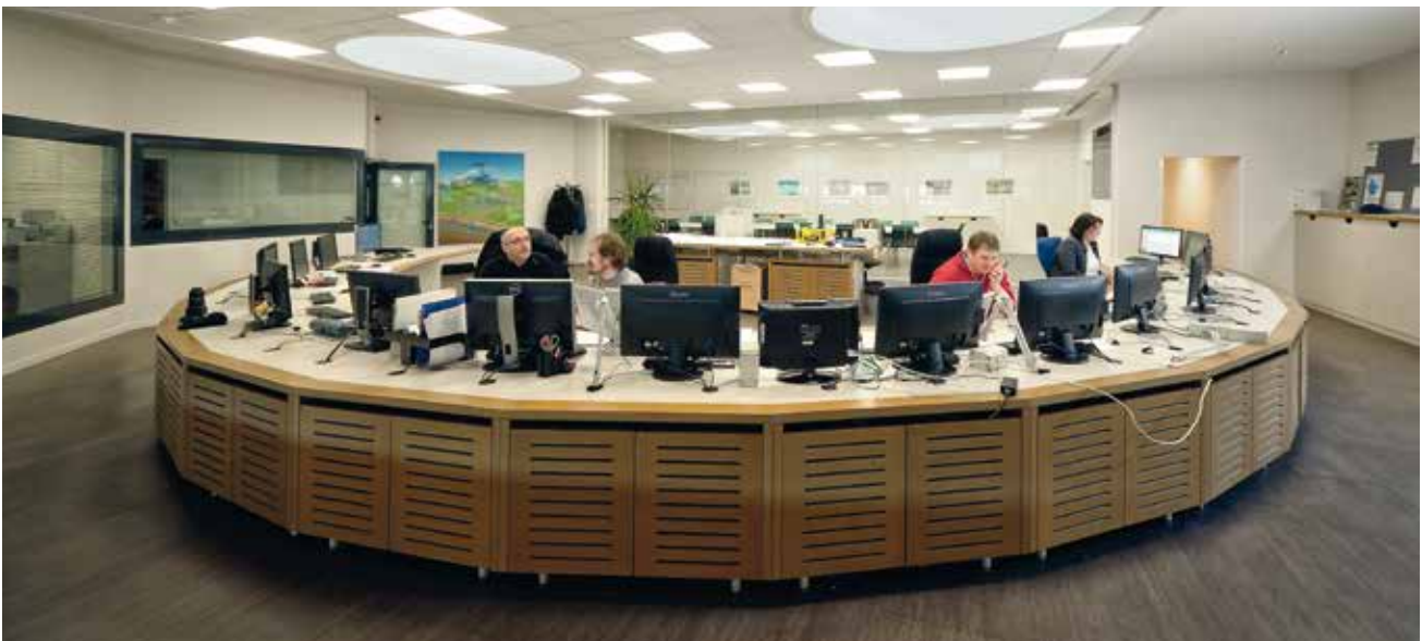
Hublo, le centre de supervision eau potable.
