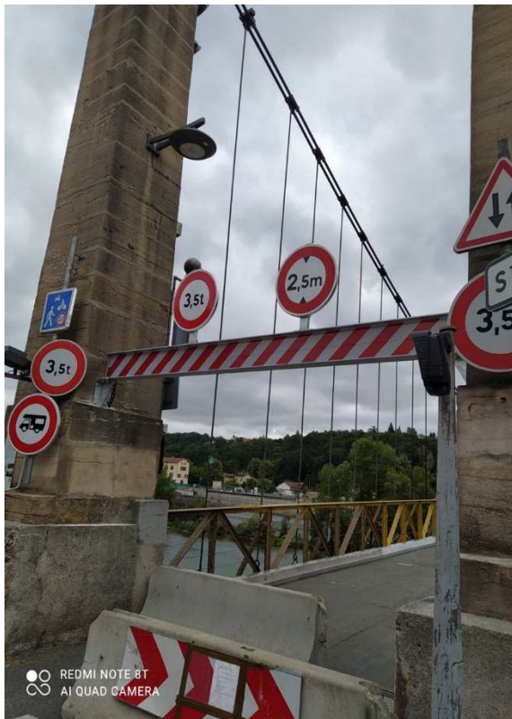
Le pont a été rénové et des portiques de sécurité ont été installés. (Photo Jacques Colignon. Métropole de Lyon.)
