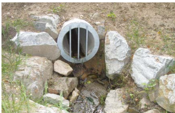
Grilles anti-intrusion et enrochement
