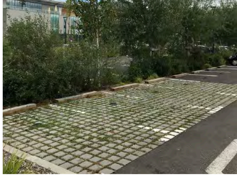
Les pavés à joints enherbés favorisent l'infiltration des eaux pluviales
